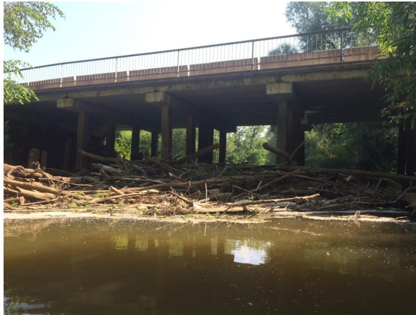
Фото 4 - Завал моста автодороги карчем через р. Сава в с. Верхняя Сава
